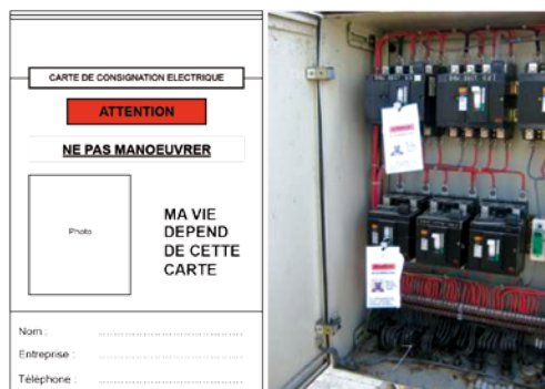
Figure 8 : Exemple d'étiquetage posé par un intervenant
